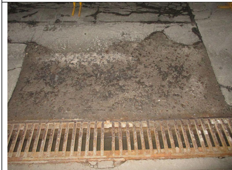
Кор.1, эт.-1 Заглубленный проезд Ремонт бетонных полов -подготовка полов к укладке бетона
