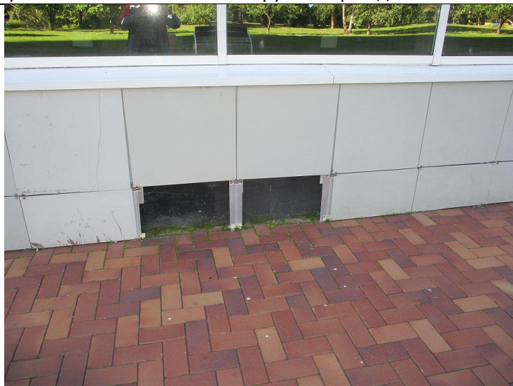
Кор.7, эт.1 Вентилируемый фасад Установка плитки на вентиляруемый фасад -установка плитки на вентиляруемый фасад
