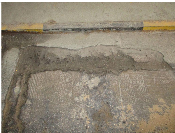
Кор.1, эт.-1 Заглубленный проезд Ремонт бетонных полов -приготовление и укладка бетонной смеси
