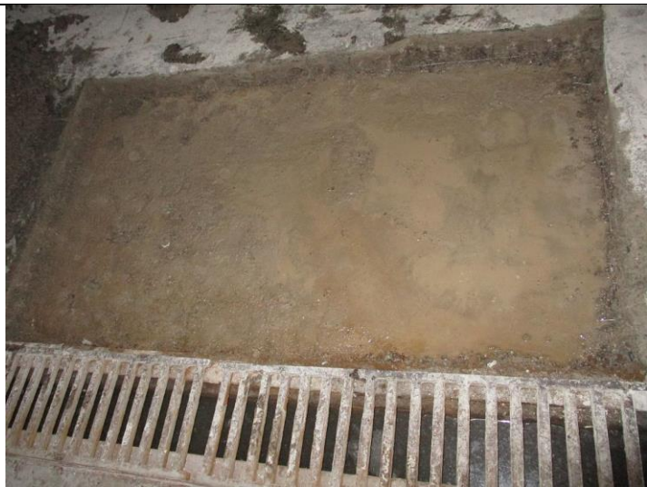
Кор.1, эт.-1 Заглубленный проезд Ремонт бетонных полов -приготовление и укладка бетонной смеси
