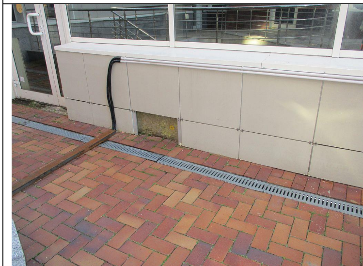
Кор.7, эт.1 Вентилируемый фасад Установка плитки на вентиляруемый фасад -установка плитки на вентиляруемый фасад
